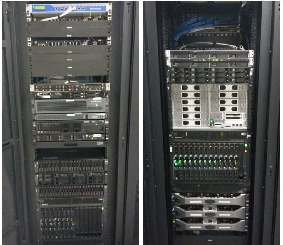
Figura 4.1. Racks Infraestructura CEDIA – Datacenter ETAPA EP
