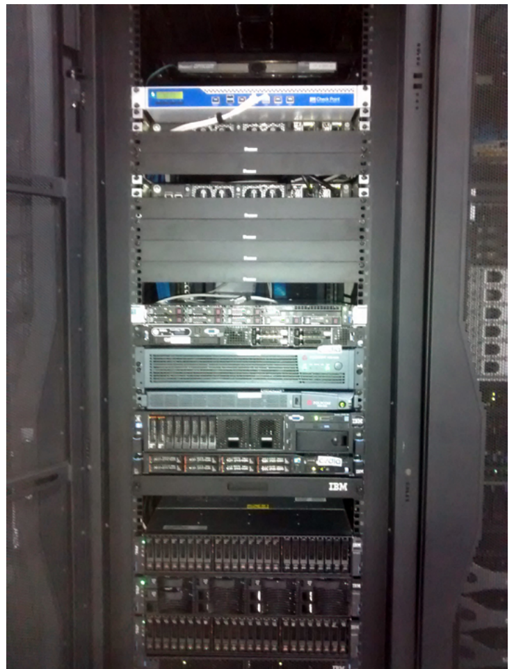
Figura 40. Datacenter ETAPA- Racks de CEDIA
